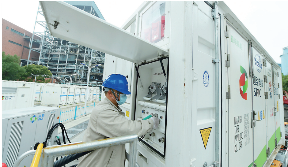
在充电站，工作人员为电池充电，380V交流电经过充电桩转换为720V直流电
